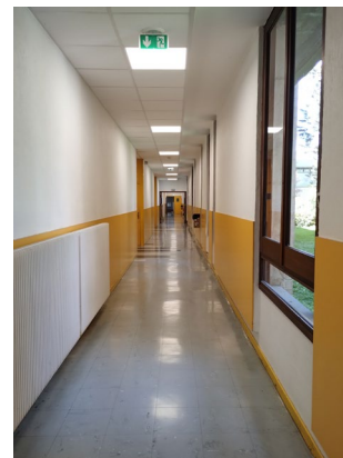
Faux plafond en dalles amovibles
