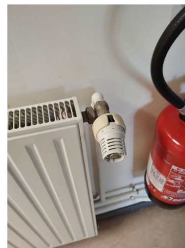
Emetteurs de chauffage (RDC sur patio)
