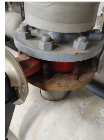
Présence de corrosion
