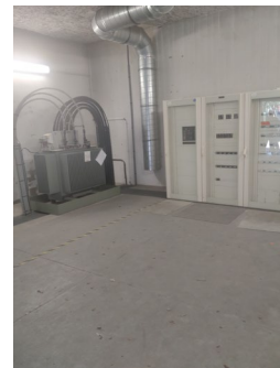
Transfo + TGBT, Bât. J
